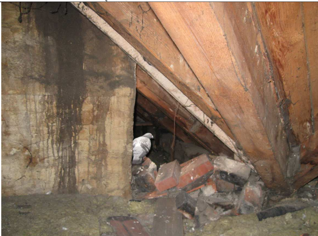
Fot. 7 Fragment więźby w koszu dachowym na styku obu segmentów.
