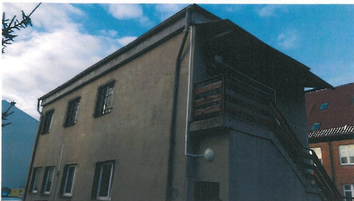
Fot. 3. Elewacja południowa ze schodami zewnętrznymi do rozbiórki
