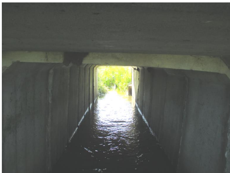
Fot. 9 Przemieszczenie pionowe prefabrykatu przewodu
