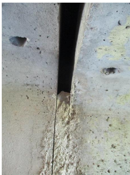
Fot. 10 Rozwarcie styku prefabrykatów przewodu, widoczne prace naprawcze wypełniające szczelinę
