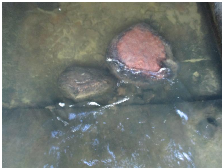
Fot. 11 Próg po stronie wylotu przepustu powstały w wyniku przemieszczenia pionowego elementów przewodu
