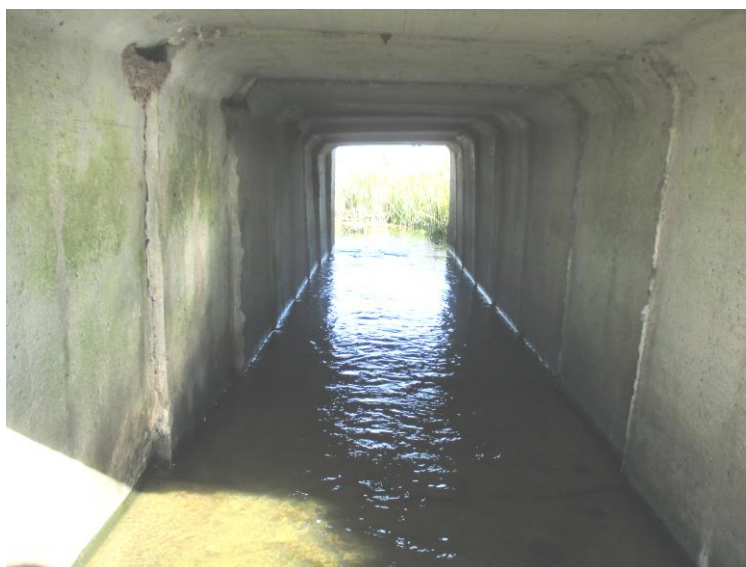
Fot. 8 Przewód przepustu, widoczne przemieszczenia poziome prefabrykatów przewodu
