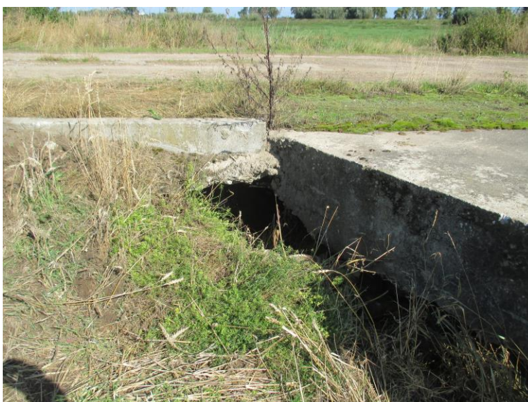
Fot. 14 Wymyta przez wodę opadową skarpa korpusu drogi po stronie wlotu przepustu
